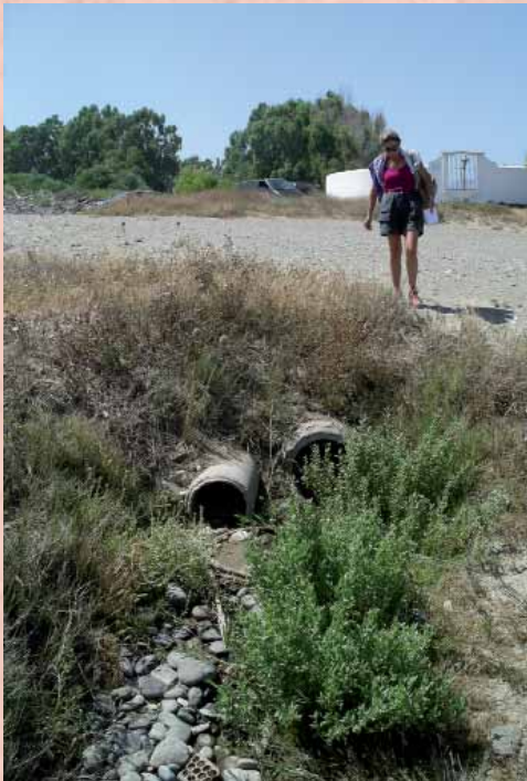
Figura 212. Vertido de aguas residuales en las inmediaciones de la Punta del Saladillo. Foto: J. Gómez Zotano.
